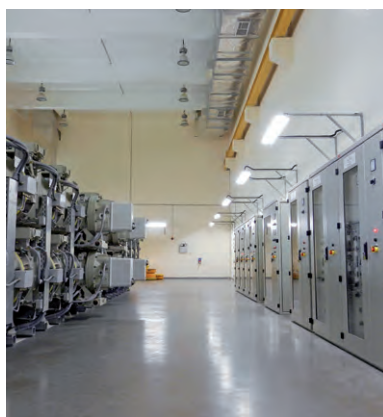
132 kV GIS Hall, U. A. E.
